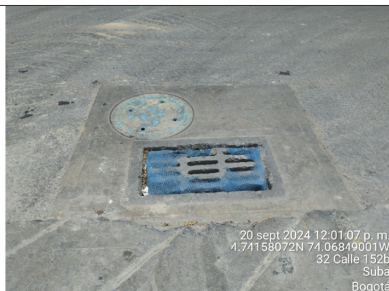
Fotografía 10. Mallas desgastadas de los sumideros. Visita del 20 de septiembre de 2024.
