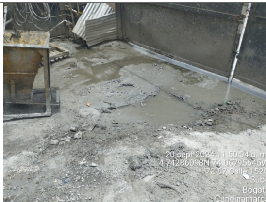
Fotografía 6. Mezcla y lavado de motobomba directamente en suelo. Visita del 20 de septiembre de 2024.
