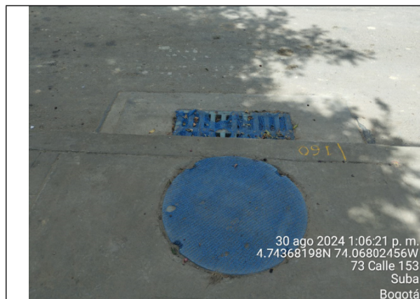
Fotografía 9. Mallas desgastadas de los sumideros. Visita del 30 de agosto de 2024.
