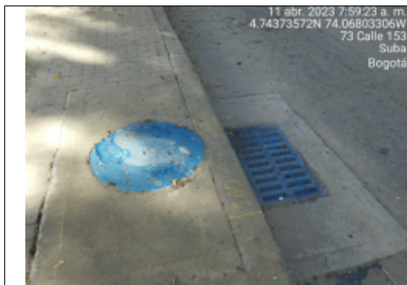
Fotografía 7. Limpieza constante a sumideros. Visita del 11 de abril de 2023.
