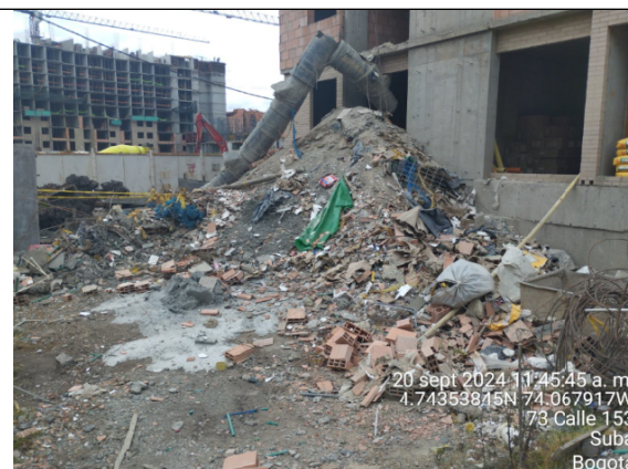
Fotografía 12. Residuos de construcción y demolición mezclados. Visita del 20 de septiembre de 2024.
